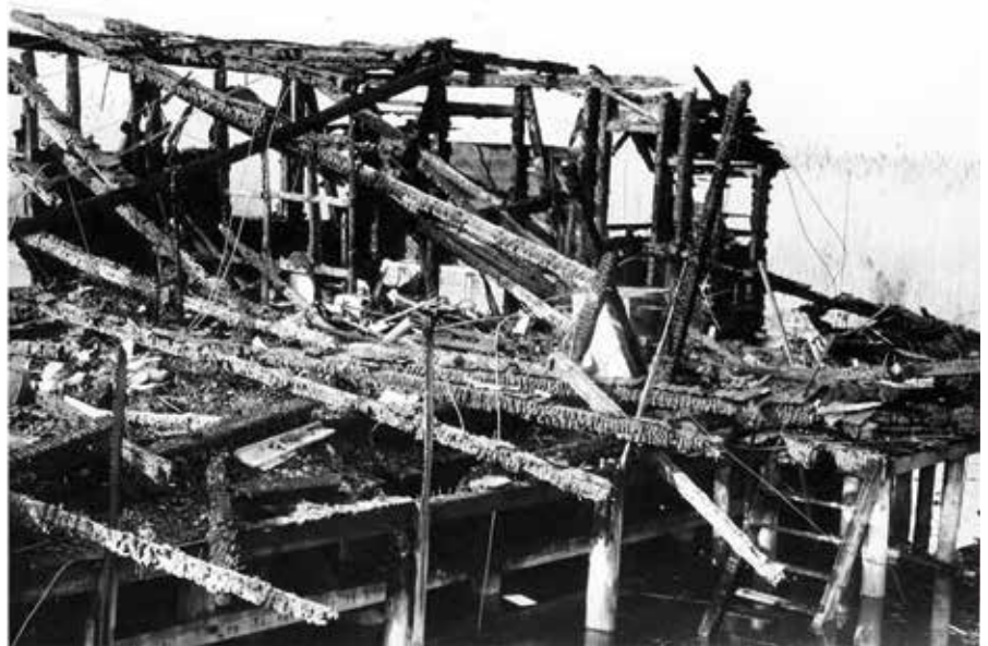
■ oben: Die Folgen des Brandes vom 25. Februar 1960 – der Brand betraf vor allem das Hauptgebäude der Biologischen Station.
