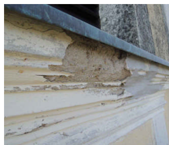
Schäden am Kirchturm durch Wassereintritt und Frostabsprengungen
